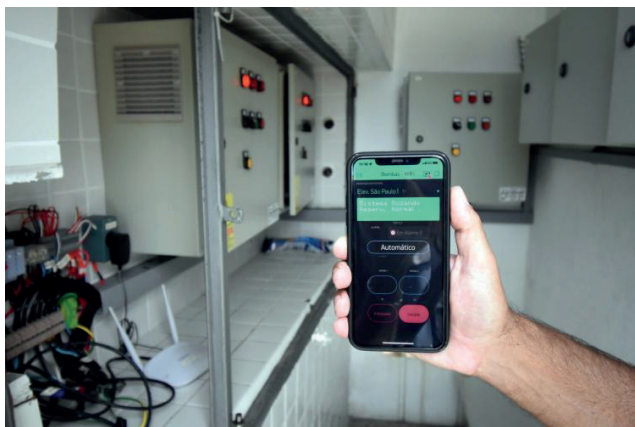
Figura 02: Demonstração da utilização do sistema de automação das estações elevatórias
