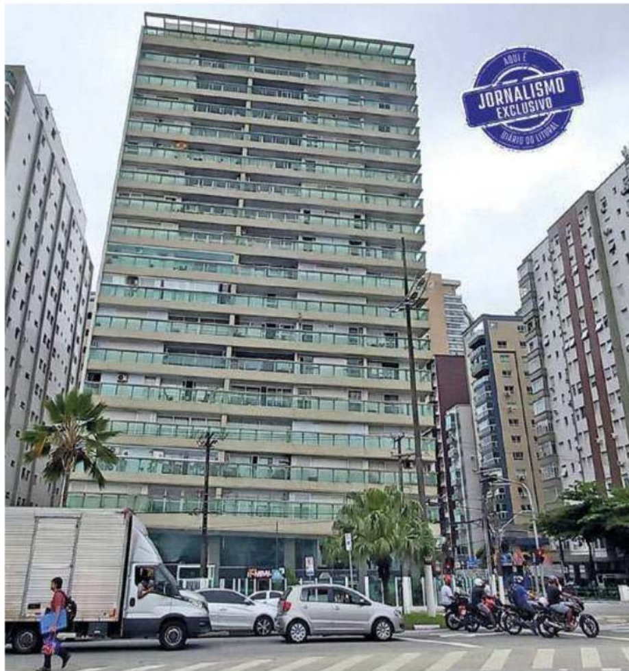
Prédio torto de Santos: solo de argila praiana e incapacidade das construtoras à época de aprofundar fundações até a 1ª camada de rochas
