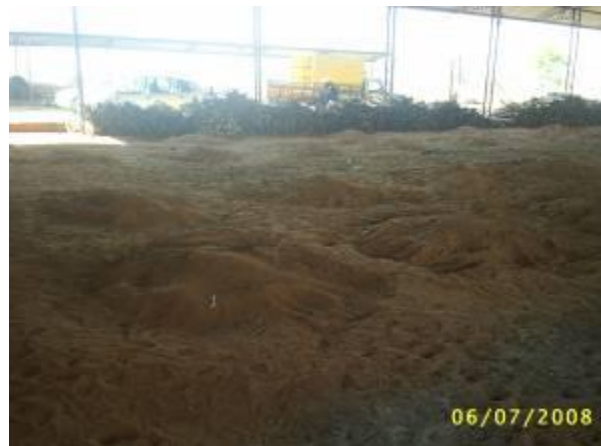
Figura 2: Buracos tampados com a terra.
