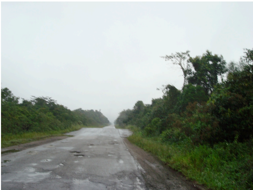
Figura 4. Precariedade no estado das estradas Fonte: Pereira (2008)
